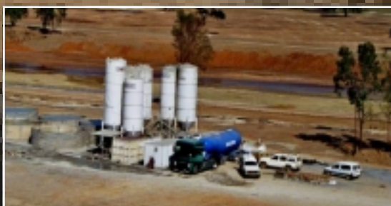
Bentonit till den yttersta tätningen tillverkas på plats. Bredvid tornen syns de blivande dräneringsbrunnarna.
