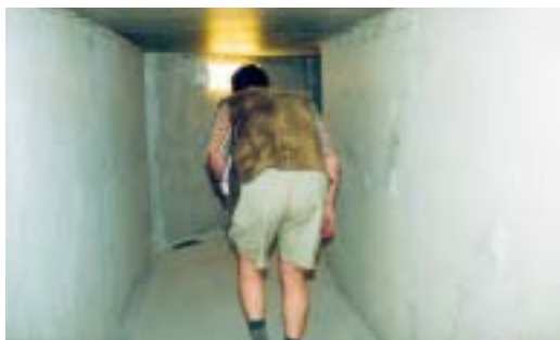
Jordledning/kulvert där luften leds in till skolans lokaler.
