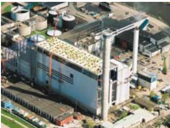
Flygfoto från i början av maj. Skorstenen är klar, glasning av fasaden och isolering av taket pågår.
