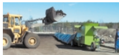
Lastning av kompostmaterial hos Ragnsells. Bakom syns strumpan som fylls med kompostmaterial.
