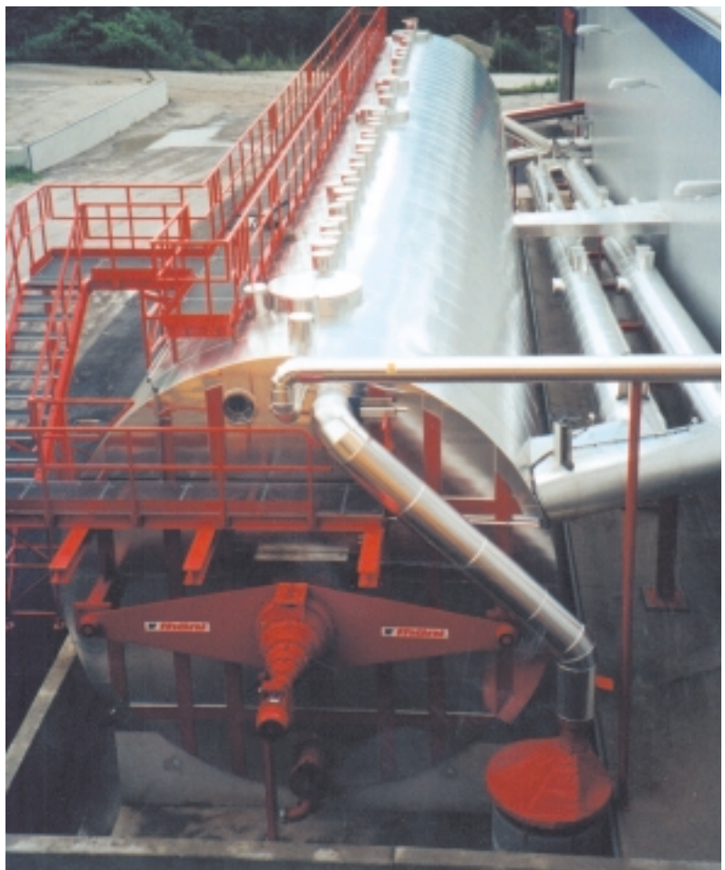
Den liggande röt-kammaren, volym 900 m3, Roppens biogasanläggning.
