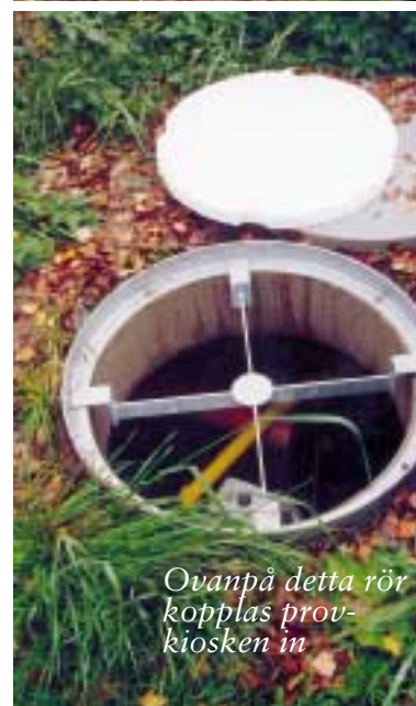
Provtagnings systemet. En flaska fylls per dag genom tidsstyrd automatik.
