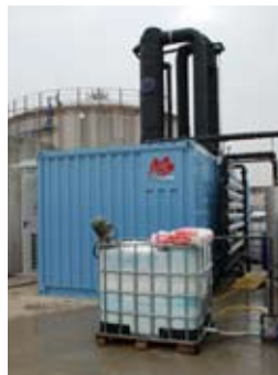
Tecnologia dello strippaggio e complessazione dell' \text{NH}_3 con \text{H}_2\text{SO}_4 (AB IMPLANTI)
