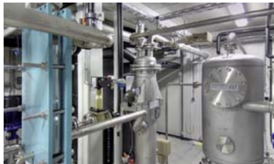
Impianto di biometano MT-ENERGIE (Germania)
