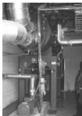
Kondensorn som gör värme av avloppsången.
