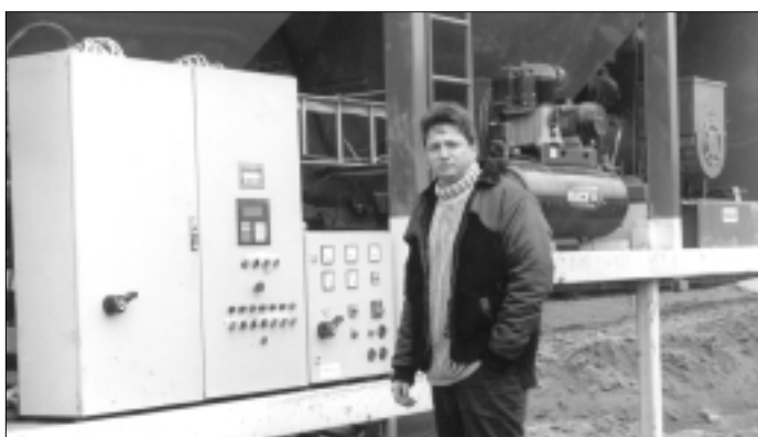
Bo Fransman framför kontrollenheten.
