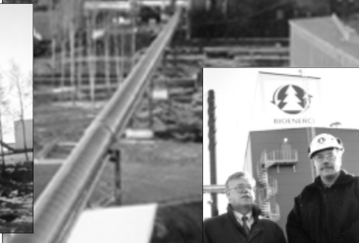
Torkgasrör från kraftvärmeverket. Röret till vänster är hyttgas från stålverket.
