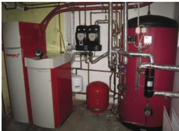
Serviceavtalet håller anläggningen i topptrim
