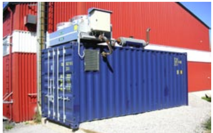
Denna container rymmer kraftvärmeverket hos Sörab i Vallentuna.
