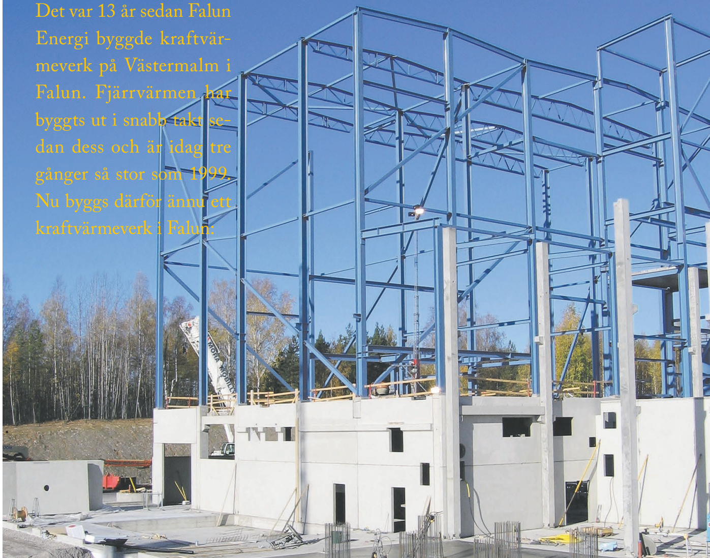
Skalet till det nya kraftvärmeverket i Falun håller på att ta form
