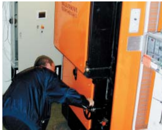
Hans Nilsson, Riksbyggen, inspekterar en ny panna i Floda.
