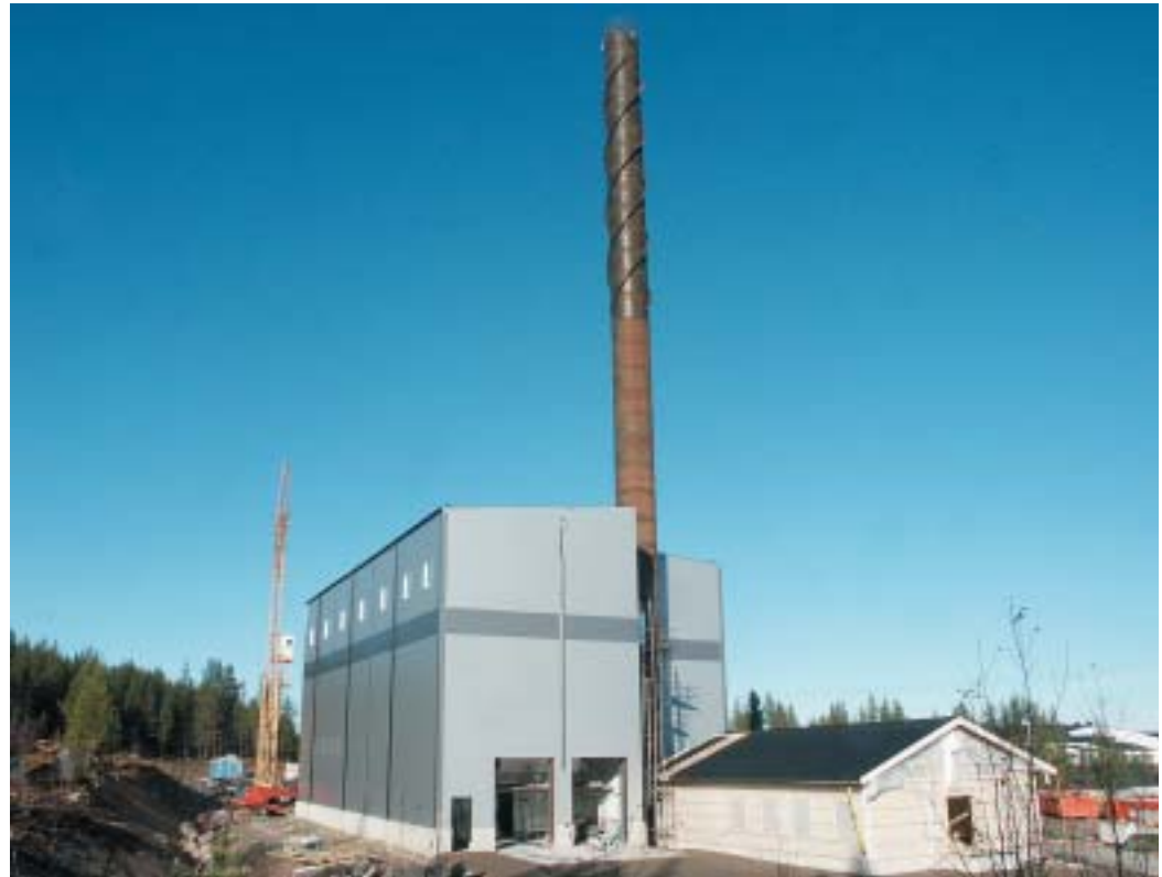
Biobränslepannan har en effekt på 9,8 MW. Bilden från början av oktober.
