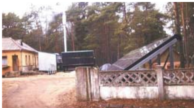
Den gamla panncentralen till vänster, den nya i mitten och solfångarna till höger.
