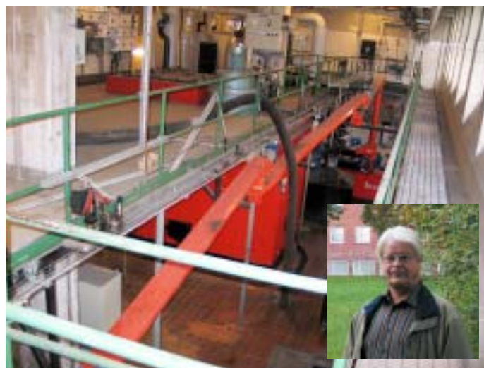
Ett antal korta raka skruvar matar bränslet från silon till pannan. Kjell Lindström på Klm Energi och Mekanik ansvarade för leveransen av pelletanläggningen från Lin-ka.
