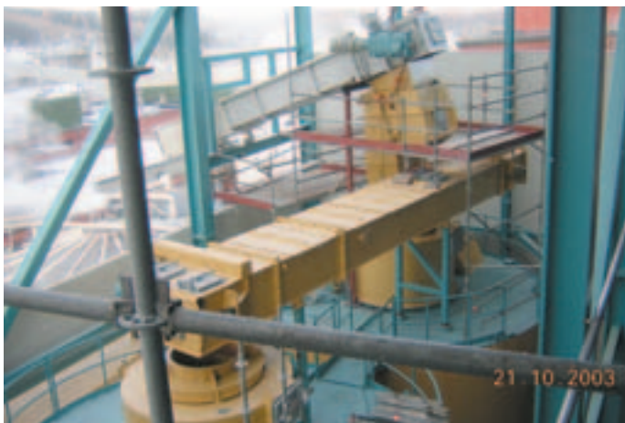
Biobränslet tas emot i pannhuset och mellanlagras i två 150 kubikmeters silos.
