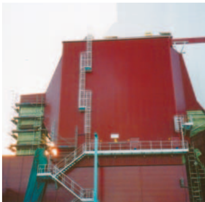
Elfiltret är 15 meter högt och 8 meter brett och kan rena 565 000 kubikmeter rökgaser per timma.
