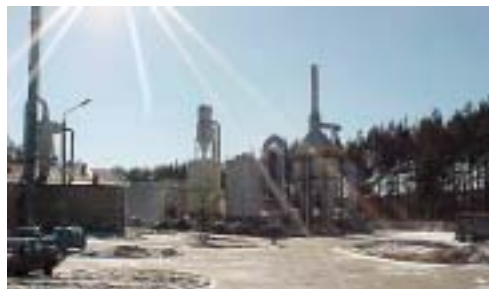
VTS har designat torken och levererat brännare till pelletfabriken.
