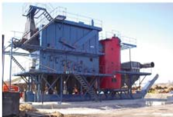
Montage Nyby Säg 12 MW.
