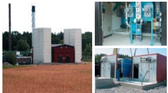
Anläggningen består av två ihopbyggda 3 MW panncentraler.
