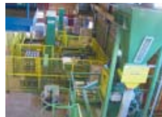
Säckningsanläggning, framtill höger fylls och svetsas säckarna, längst bort till vänster läggs säckarna automatiskt på pall och plastas in.
