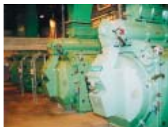
Pelletspressar på rad i Bioenergi i Norrlands pelletsfabrik i Luleå.
