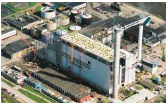
Flygfoto från i början av maj. Skorstenen är klar, glasning av fasaden och isolering av taket pågår.
