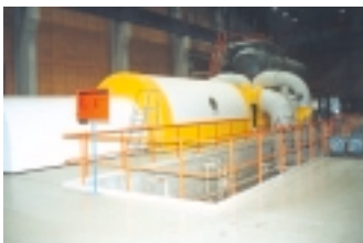
Turbinhall med generator
