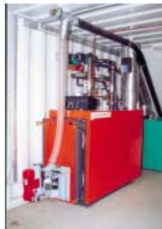
En Iwabo under installation i en fristående container central.
