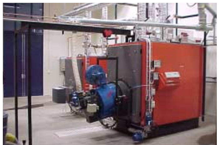
SBS Bioburner 400 kW levererad av Kvänum Energi till Jönköpings Energi för en anläggning i Husvarna. Olja används som reserv och som topplast.
