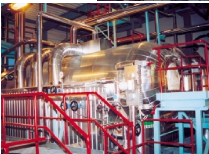
I hörnan syns elevatoren som för upp bränslet till en liten inmatningssilo på 20 kubikmeter - på pannväggen.
