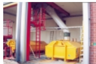
Silo för flygaska respektive container för bottenaskan. Flygaskan skall när systemet är utbyggt återföras till skogen. Bottenaskan deponeras.
