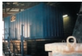
Till höger ser själva askpelleteringsanläggningen.
