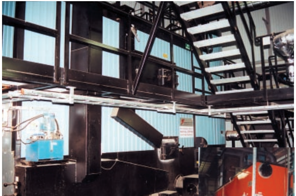
Järnforsen pannan på 2,5 MW som ger energi till torken.
