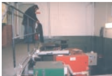
Pannrummet från ovan, längst bort står pelletspannan. Utanför till höger finns bränslesilon.
